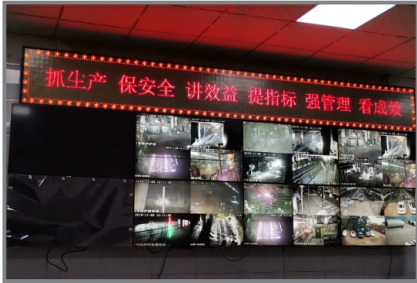
汉中钢铁主操控室
